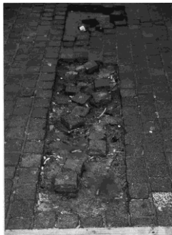
Εικόνα 1. Μη λειτουργική και κακότεχνη επίστρωση πεζοδρόμου με κυβολίθους.
