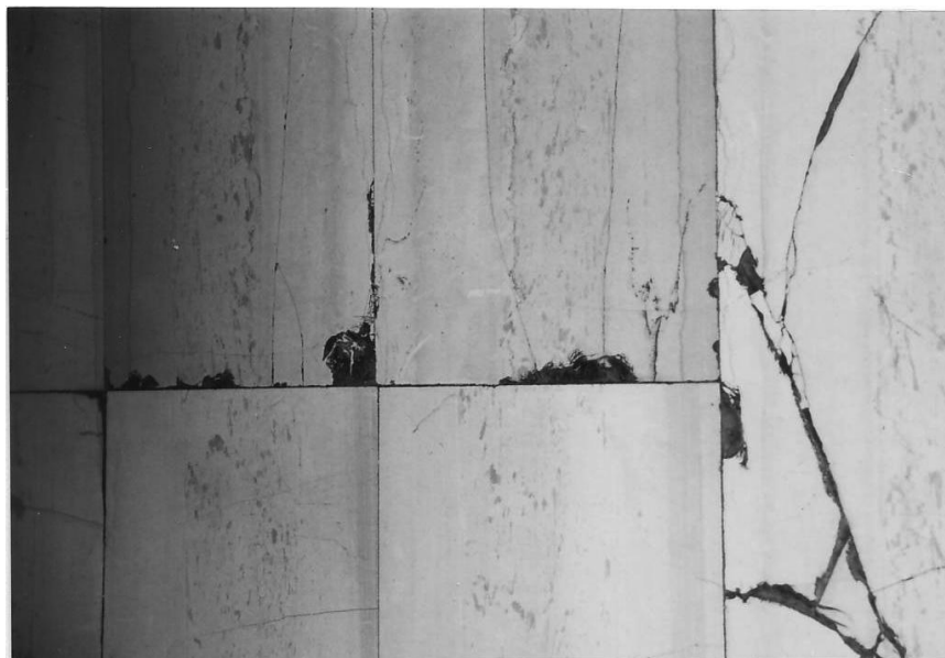
Εικόνα 3. Δαπεδόστρωση με ασβεστολιθικές πλάκες. Αποφλοιώσεις στους αρμούς.
