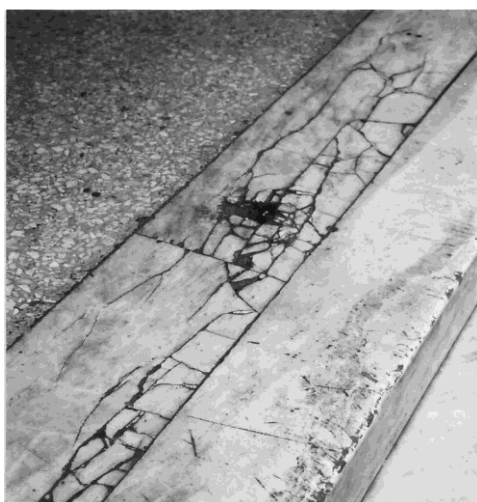
Εικόνα 4. Φθορά μαρμαρόπλακας από τη στερέωση γάντζου ρολών και κρούσεις.
