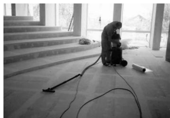
Εικόνα 23. Διαμόρφωση κερκίδων με πλωτά δάπεδα Vidifloor.
