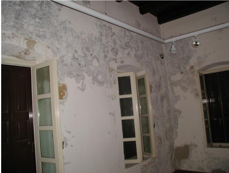
Εικόνα 3. Η ΒΑ γωνία στο εσωτερικό τμήμα του ορόφου με έντονη υγρασία και αποκόλληση βαφής.
