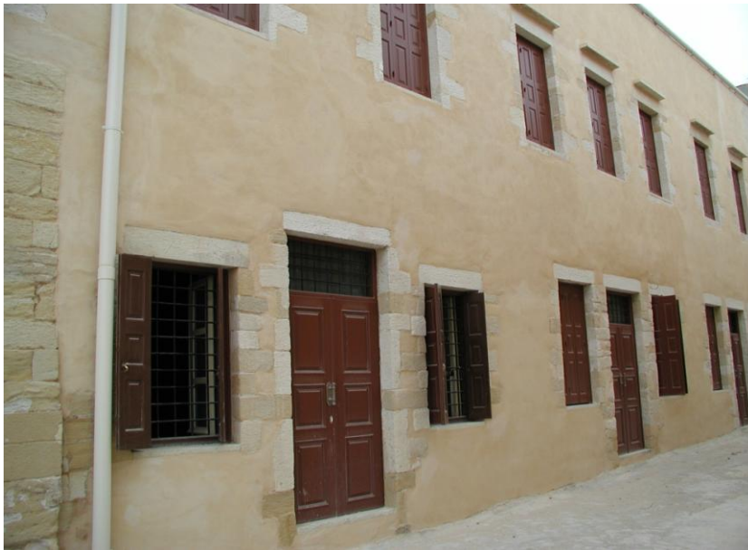
Εικόνα 8. Αποψη της βόρειας εξωτερικής πλευράς του Μουσείου Κισάμου μετά την εφαρμογή συμβατών υλικών.
