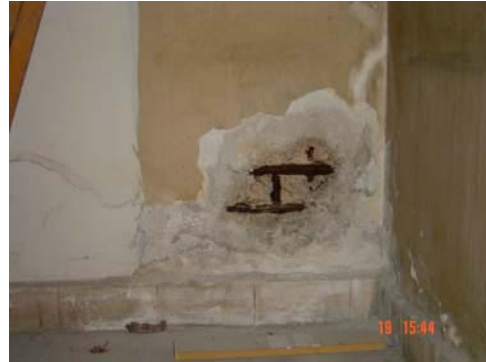
Το σημείο όπου έχει εμφανιστεί το ο.σ. στο υπόγειο.
