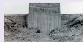
Έργο Συνδέσμου Ύδρευσης Ελευθέρων - Δεξαμενή αποθηκεύσεως ύδατος Κοιν. Ραχούλας
