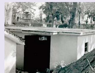
Έργο Συνδέσμου Ύδρευσης Ελευθέρων - Αντλιοστάσιο
