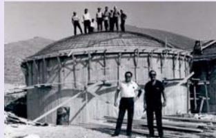
Στη δεξαμενή Δήμου Τινάβου, για την ύδρευση της πόλης, χωρητικότητας 800 κυβικών (2x400), το 1966
