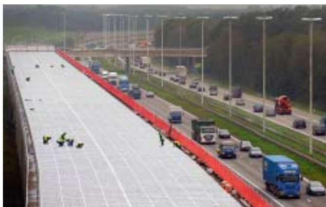
Με φωτοβολταϊκά καλύπτεται η σκεπή του τούνελ του τρένου στο Brasschaat του Βελγίου, η οποία βρίσκεται παράλληλα με τον αυτοκινητόδρομο E19. Η παραγωγή του ρεύματος θα τροφοδοτεί το δίκτυο των σιδηροδρόμων.
