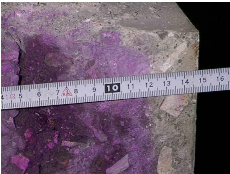
Σχ. 4.13.1 Δοκίμιο σκυροδέματος το οποίο έχει ψεκάσθει με διάλυμα φαινολοφθαλεΐνης. Το τμήμα στο οποίο δεν παρουσιάζεται αλλαγή χρώματος (δεξιά) είναι ενανθρακωμένο (βάθος ενανθρακώσεως περίπου 3cm) Το αριστερά τμήματα (χρώματος ροζ-βυσσινί) δεν έχει ενανθρακωθεί.
