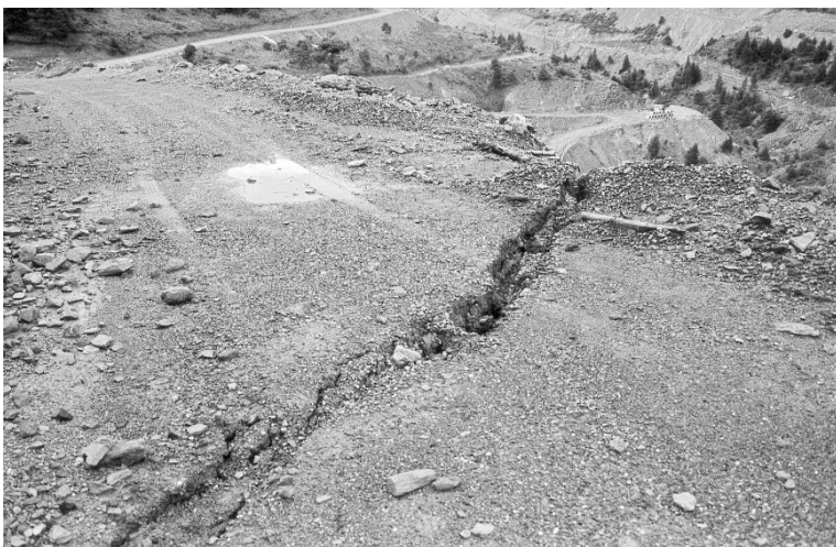
Εικόνα 9. Ρωγμή σε εργοταξιακό δρόμο δυτικά του υπερχειλιστή
