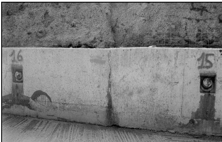
Εικόνα 6 : Μετατόπιση 1 έως 1.5 cm στον αρμό διαστολής της δοκού σύνδεσης των προεντεταμένων αγκυρώσεων στο επίπεδο του αναβαθμού +730.00 του πρανούς εκσκαφής υπεράνω του στομίου εξόδου της σήραγγας εκτροπής & υπερχειλιστή.
