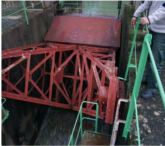
Εικόνα 9α. Ηλεκτροκίνητο τοξωτό θυρόφραγμα
