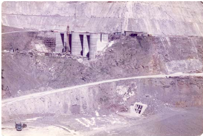
Εικόνα 6: Εκχειλιστές και Εκκενωτής Πυθμένα ΥΗΕ Σφηκιάς
