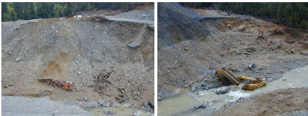
Εικόνα 5. Διατρητικός εξοπλισμός υπογείων έργων Εικόνα 6. Εκσκαφέας Κατάρρευση αναχώματος απορριφθέντων υλικών και εξοπλισμός που παρασύρθηκε. Στα πρηνή φαίνονται τα σημάδια από την ανώτατη στάθμη της λίμνης που σχηματίστηκε μετά την έμφραξη της καταβόθρας
