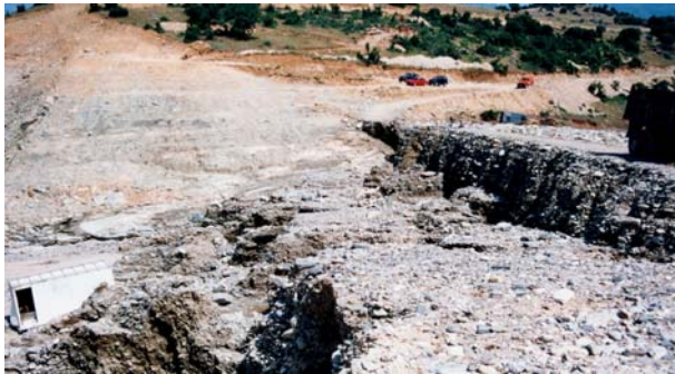
Εικόνα 4: Πλημμυρικά φαινόμενα κατά την κατασκευή
