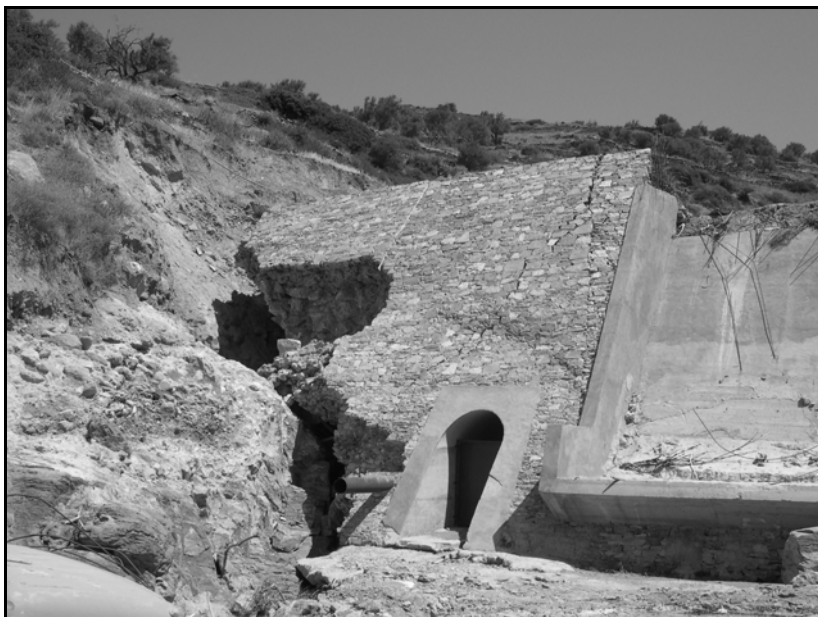
Εικόνα 4. Κατάντη όψη του φράγματος μετά την αστοχία. Διακρίνεται η διάβρωση του δεξιού αντρείσματος, το στόμιο της στοάς πρόσβασης και τμήμα του συστήματος υπερχειλίστης.
