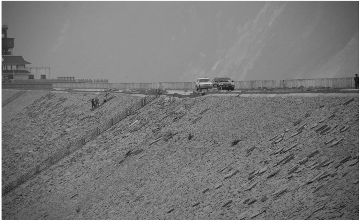
Εικόνα 6: Αποψη της καθίζησης κατά 40cm του πυρήνα του φράγματος και των συνοδών ζημιών που προκάλεσε. Πίσω από το φράγμα διακρίνονται οι τεράστιες κατολισθήσεις, που αναπτύχθηκαν στο πρυνές της λεκάνης κατάκλυσης.
