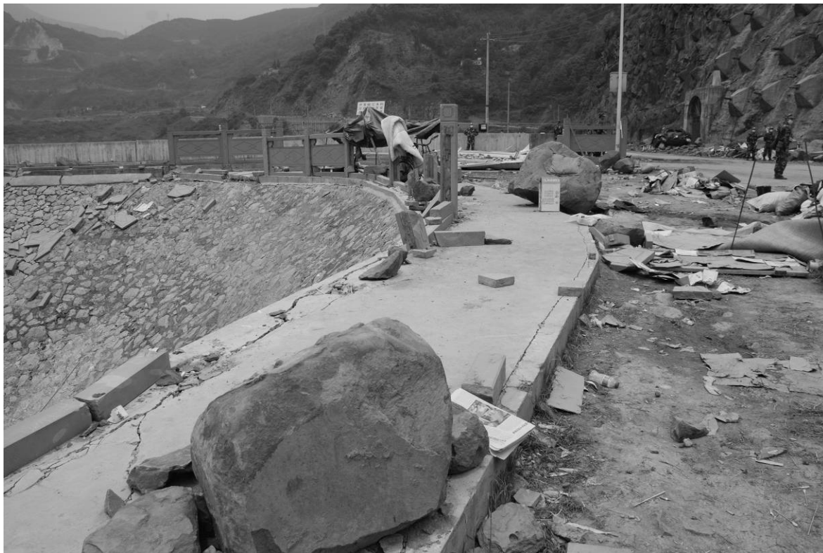
Εικόνα 9: Άποψη βραχωδών όγκων που κατολίσθησαν στο αριστερό πρανές πάνω στη στέψη του φράγματος
