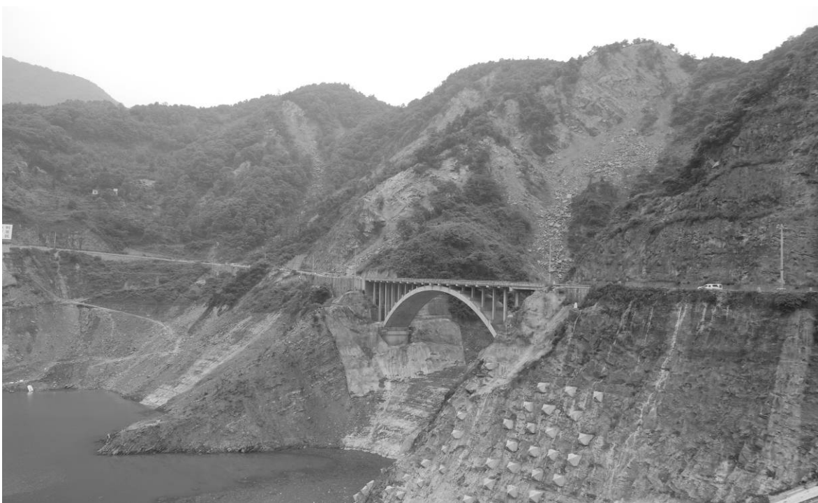
Εικόνα 11: Άποψη πρανούς, το οποίο αστόχησε παρά τα εκτελεσθέντα έργα σταθεροποίησης, που περιλάμβαναν πυκνό κάναβο αγκυρίων.
