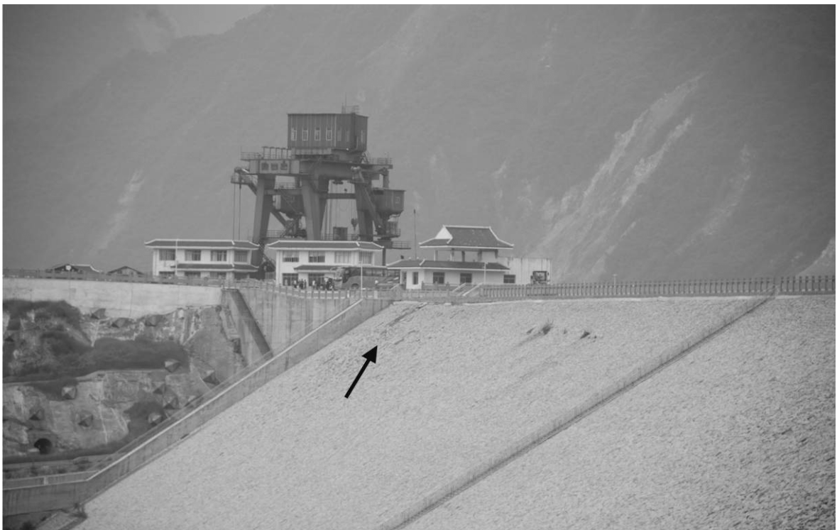
Εικόνα 5: Εγκάρσιες θραύσεις στον άξονα του φράγματος στην δεξιά πλευρά λόγω διαφορετικής καθίζησης του σώματος του φράγματος σε σχέση με το άκαμπτο τμήμα του υπερχειλιστή.
