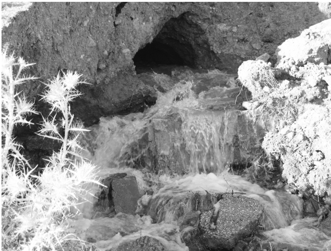
Εικόνα 2. Στόμιο εξόδου του σωλήνα σηραγγοειδούς μορφής της διόδου διαφυγής. Διακρίνεται το θολό του νερού της διαφυγής δηλωτικό των διεργασιών εσωτερικής διάβρωσης στο σώμα του φράγματος.
