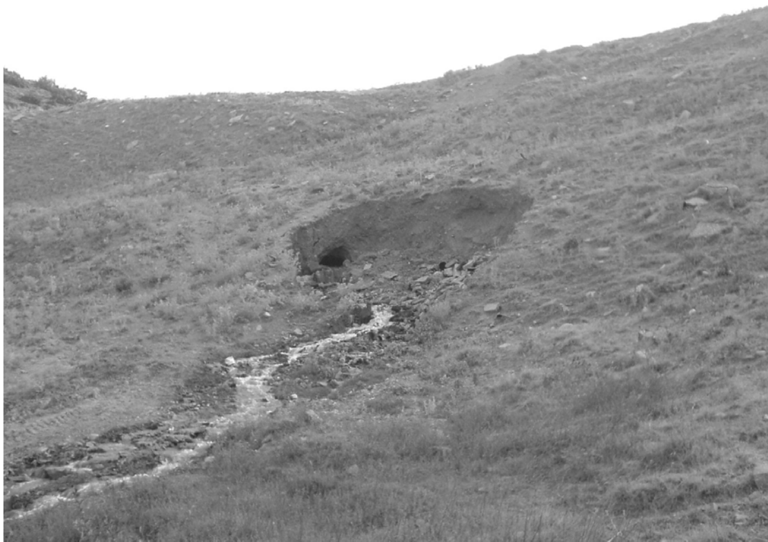
Εικόνα 1. Γενική άποψη του κατάντη πρανούς του φράγματος μετά την αστοχία τύπου διασωλήνωσης. Φαίνεται καθαρά ο σιραγγοειδής χαρακτήρας της διόδου διαφυγής.
