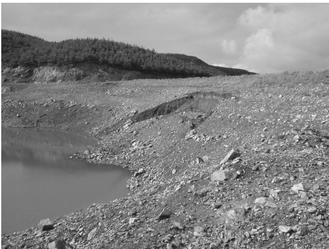
Εικόνα 3. Κατολίσθηση του ανάντη πρανούς του φράγματος, που ξεκίνησε μετά τις 10 Ιουλίου, λόγω απότομου καταβιβασμού της στάθμης του ταμιευτήρα. Η φωτογραφία ελήφθη στις 24 Ιουλίου.
