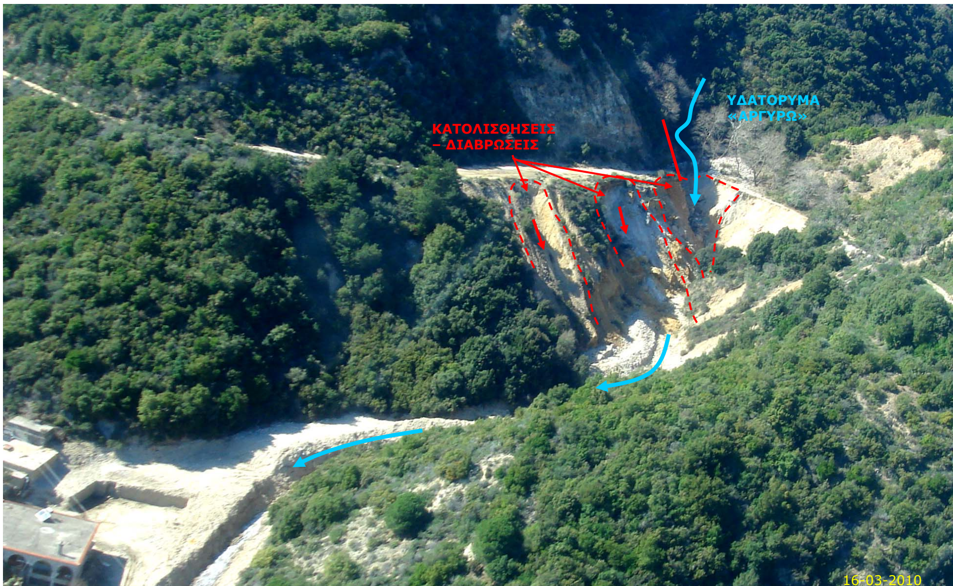
ΕΙΚΟΝΑ 9. Η αστοχία στο σημείο διασταύρωσης της παλαιάς επαρχιακής οδού Στρατωνίου-Ολυμπιάδος (Θέση R1) (Πηγή φωτογραφίας: Αρχείο Δήμου)
