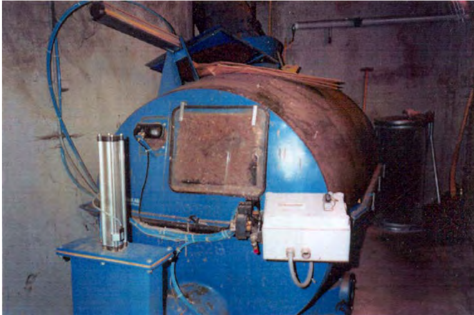
Εικόνα Γ33. Δεξαμενή απορριμμάτων σε υπόγειο κτιρίου που εκκενώνεται εξωτερικά με αναρρόφηση.
