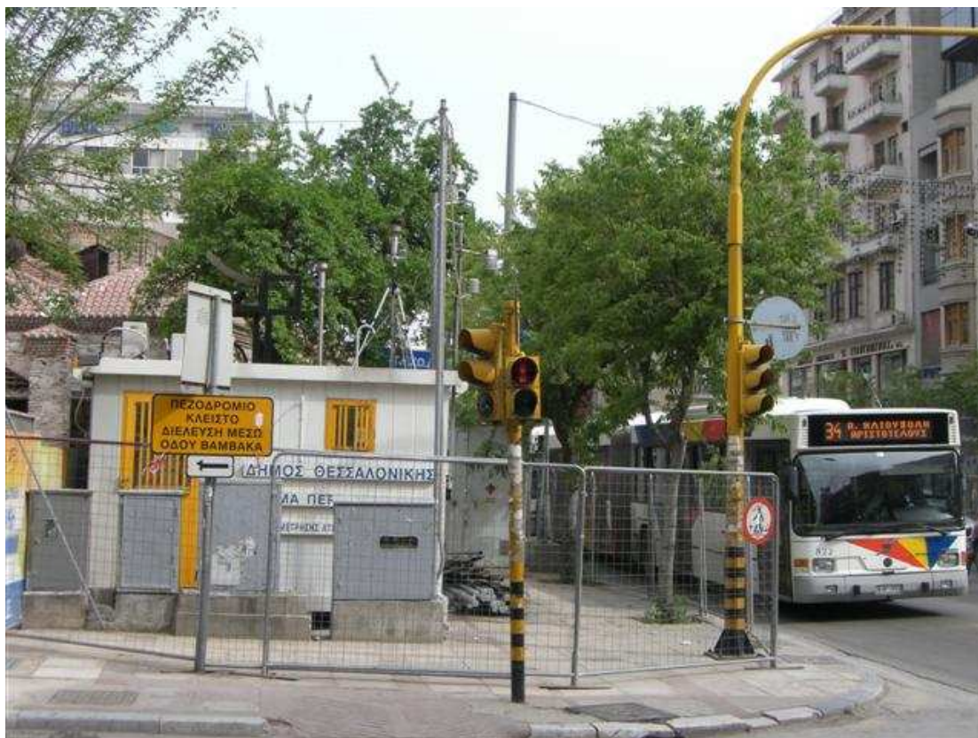
Εικόνα 29: Καθοδήγηση πεζών σε παράκαμψη αποκλεισμένου πεζοδρομίου. Η πινακίδα είναι τοποθετημένη σε θέση που δεν γίνεται εύκολα αντιληπτή από τους πεζούς
