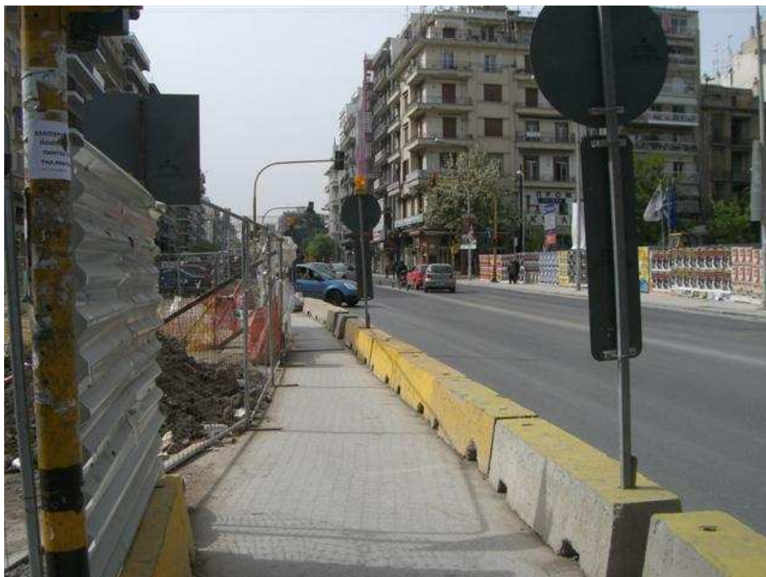
Εικόνα 27: Διάδρομος παράκαμψης εργοταξίου σταθμού Αγίας Σοφίας. Απουσιάζουν μέτρα προστασίας των πεζών από τα οχήματα
