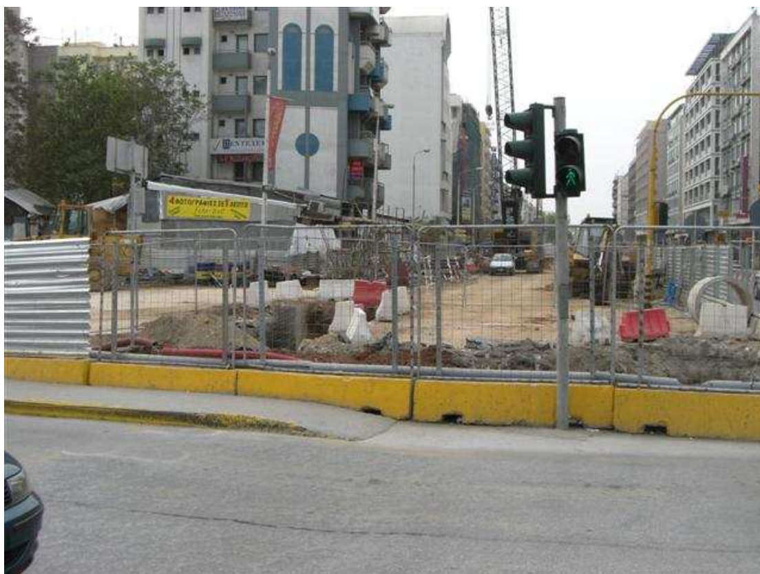
Εικόνα 32: Βύθιση προσωρινού πεζοδρομίου για διευκόλυνση ΑΜΕΑ (σταθμός Συντριβάνι)
