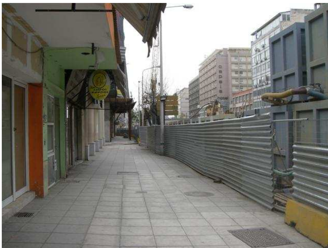
Εικόνα 34: Πεζοδρόμιο δίπλα από το εργοτάξιο σταθμού Δημοκρατίας. Το διαθέσιμο για την κυκλοφορία πεζών πλάτος ελάχιστο μικρότερο από αυτό πριν την εγκατάσταση του εργοταξίου
