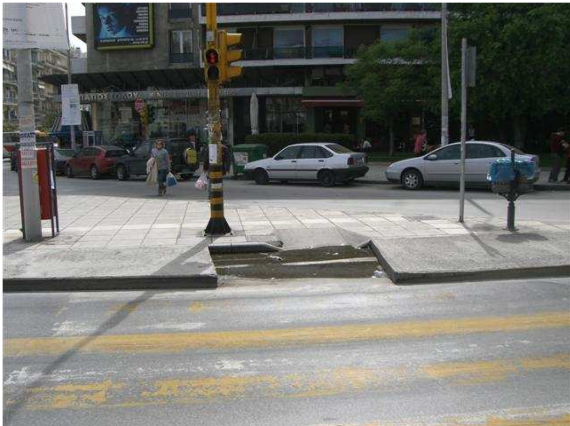
Εικόνα 22: Λιμνάζοντα ύδατα σε διαμόρφωση πεζοδρομίου με ράμπα ΑΜΕΑ στο σταθμό Συντριβάνι
