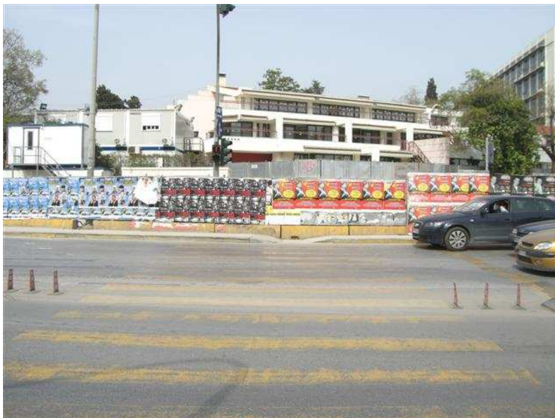
Εικόνα 25: Βύθιση προσωρινού πεζοδρομίου για διευκόλυνση ΑΜΕΑ (σταθμός Συντριβάνι)
