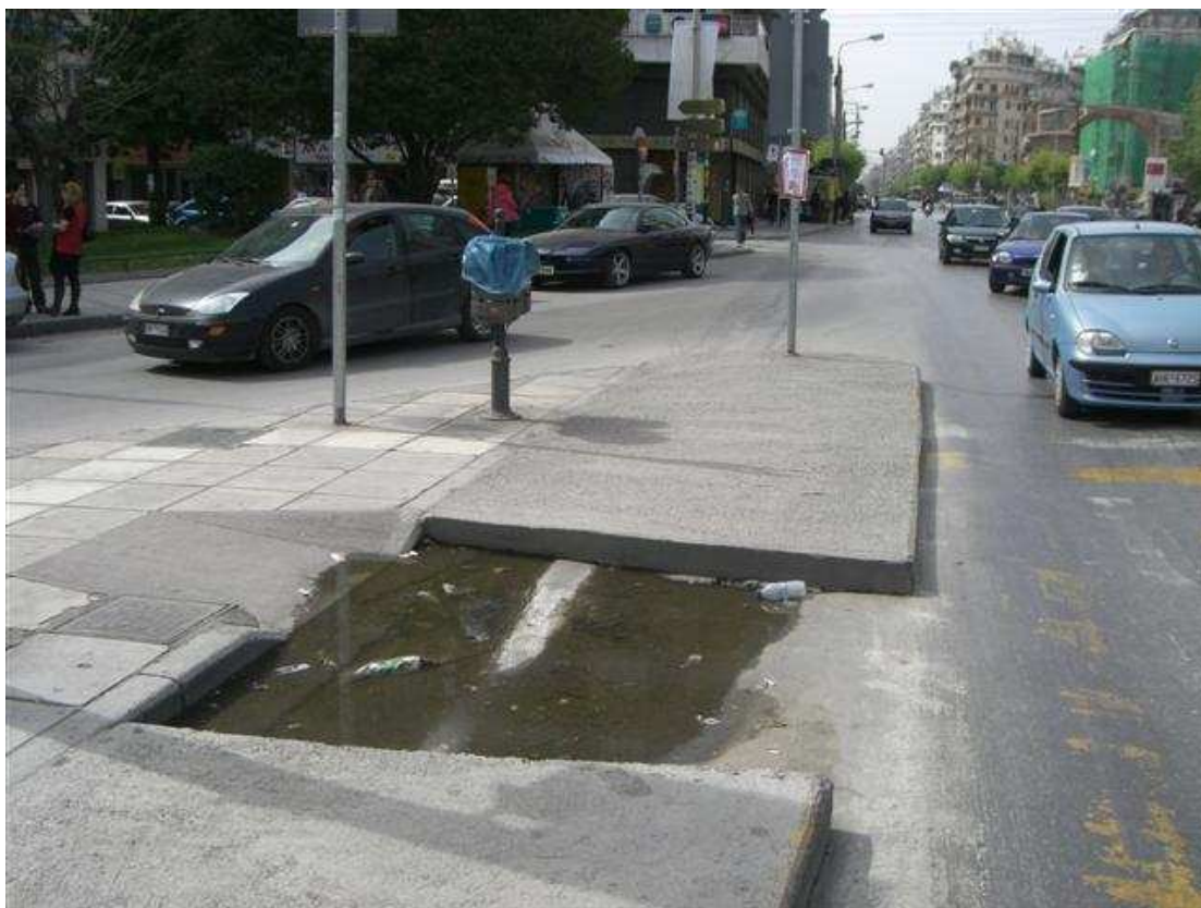
Εικόνα 23: Λιμνάζοντα ύδατα σε διαμόρφωση πεζοδρομίου με ράμπα ΑΜΕΑ στο σταθμό Συντριβάνι
