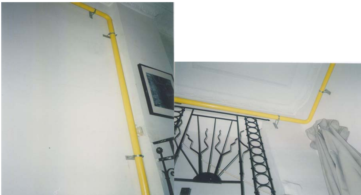
Σωληνώσεις εσωτερικά, στον χώρο κεντρικής εισόδου.
