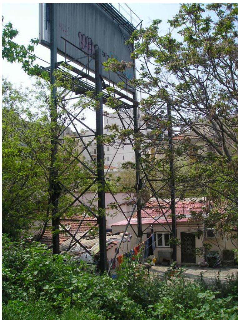
Φωτ. 41 Μεταλλική υπερκατασκευή διαφημιστικής πινακίδας επί της οδού Κ.Καραμανλή αμφίβολης στατικής επάρκειας και κατά παράβαση των νομικών διατάξεων
