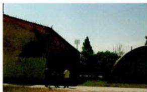
13 Στρατόπεδο «Παπακυριαζή», αποθήκη δυτ. τομέα, σε μέτρια κατάσταση.
