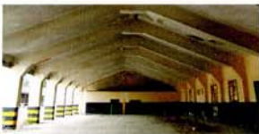
20 Στρατόπεδο «Καρατάσιου», Όρχος οχημάτων με σκελετό από οπλ. σκυρόδεμα και πλινθοδομές πλήρωσης.
