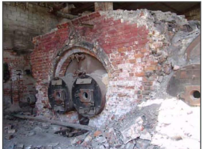
Άποψη των ατμολεβήτων που βρίσκονται στο κτίριο 16.
