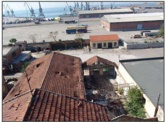
Άποψη των στεγών των κτιρίων 10 και 11, όπου διακρίνονται οι φθορές και η τμηματική κατάρρευση τους.
