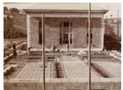
Κατασκευή μπετόν αρμέ στο Robert College, 1910, εργολάβοι Μάρκος Λάγγας, Giulio Mongeri, Eduardo de Nari
