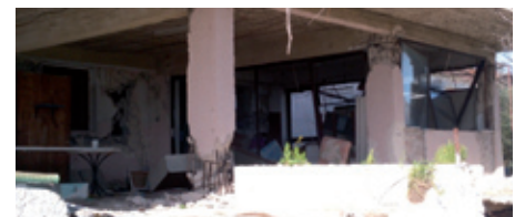
Φωτ. 5. Κτίριο στο χωριό Λιβάδι βόρεια του Ληξουρίου, διώροφο, που κτυπήθηκε από τον πρώτο 26-1-2014 (πάνω) και δεύτερο σεισμό της 3-2-2014 (κάτω). Η επιβάρυνση από τον δεύτερο είναι ιδιαίτερα μεγάλη. www.itsak.gr
