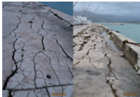
Οι κρηπίδοστοχοι του Λιμανιού του Ληξουρίου καταστραμμένοι από την σφοδρότητα του σεισμού της 3/2/2014 (δευτερος σεισμός). www.itsak.gr
