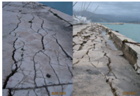
Οι κρηπίδοστοι του Λιμανιού του Ληξουρίου καταστραμμένοι από την σφοδρότητα του σεισμού της 3/2/2014 (δευτερος σεισμός). www.itsak.gr
