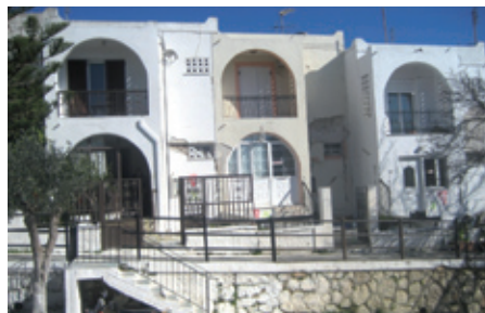
Φωτ. 2. Οι γνωστές εργατικές κατοικίες που ήδη από τον πρώτο σεισμό πρώτο 26-1-2014 (πάνω) είχαν ζημιές. Μετά τον δεύτερο σεισμό της 3-2-2014 (κάτω) οι βλάβες έγιναν εντυπωσιακά πιο έντονες. www.itsak.gr
