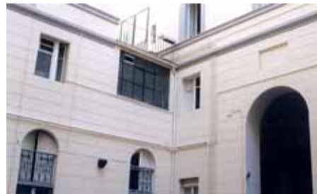
Σε εσωτερική αυλή του διατηρητέου κτιρίου όλες οι σωληνώσεις, βάφονται στο χρώμα των τοίχων ή των αρχιτεκτονικών στοιχείων του.
