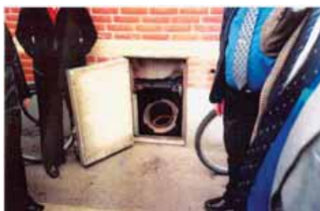
Εικόνα 4. Στόμιο αναρρόφησης απορριμμάτων από εσωτερικό κτηρίου (όψη από το εξωτερικό του κτηρίου, επί του πεζοδρομίου).
