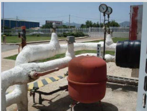
Σχήμα 2.2.16. Στα δίκτυα ψυχρού / θερμού νερού έχουν εγκατασταθεί καταλλήλου μεγέθους κλειστά δοχεία διαστολής.
