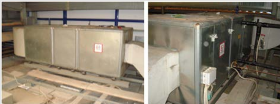
Σχήμα 2.2.9. Κεντρική Κλιματιστική Μονάδα
