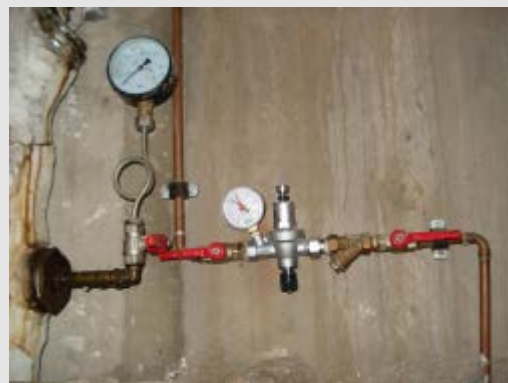
Σχήμα 2.2.17. Η πληρότητα των εγκαταστάσεων εξασφαλίζεται από το δίκτυο νερού πόλης μέσω των αντίστοιχων αυτόματων πλήρωσης.
