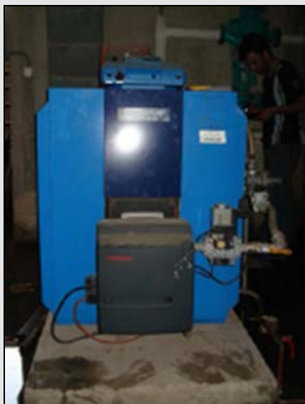
Σχήμα 2.2.5. Λέβητας παραγωγής θερμού νερού
